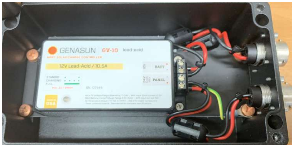
Figuur 22: Dit is de binnenkant van de behuizing. We zien de nieuwe charge controller met bekabeling richting de connectoren, waaromheen ferrietklemmen zijn geplaatst. Daarnaast is te zien dat de charge controller geaard is aan de behuizing. Dit zijn allemaal extra maatregelen om de ruis te onderdrukken.
